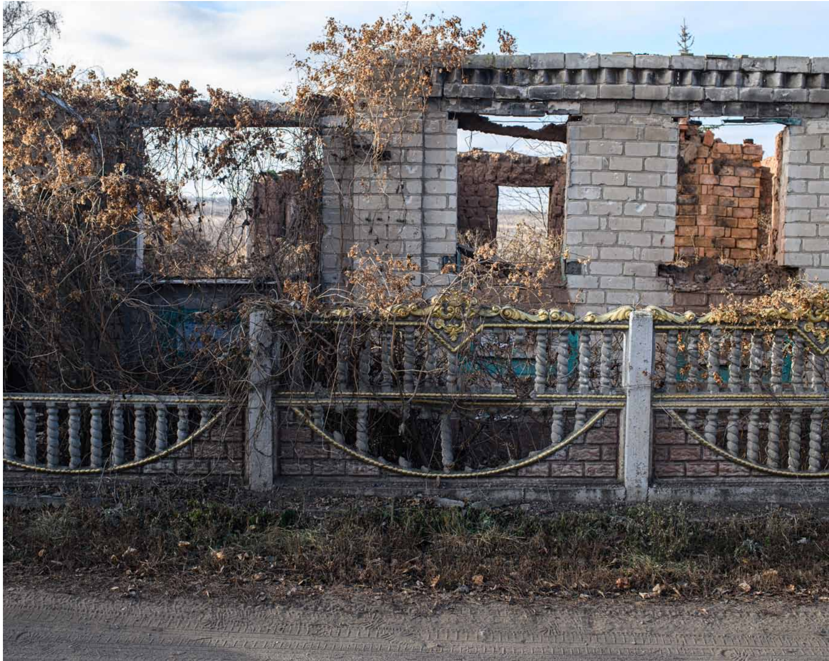
Une maison détruite dans le village de Zaitsevo.
