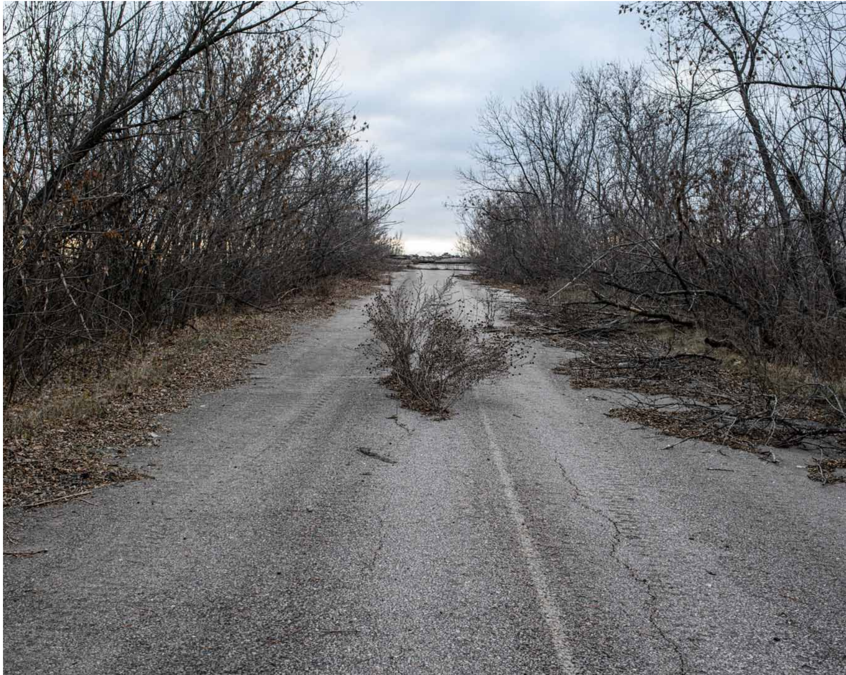
La Route T0516, aux environs du point de passage de Mayorsk contrôlé par les forces ukrainiennes, est bloqué par un pont détruit après un bombardement.
